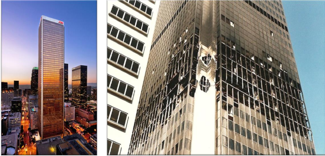
Resim 26-27. Düz cephe geometrisinde “alev saptırıcı” herhangi bir girinti çıkıntı veya elemanın olmaması sebebiyle cephe yüzeyinde yaklaşık 9,5-10 m alev yüksekliği olmuştur.
